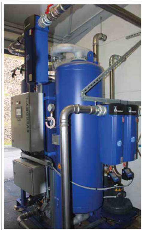
El secador de adsorción con regeneración de calor EVERDRY® modelo FRA-V es el corazón de la instalación de tratamiento de aire comprimido.
