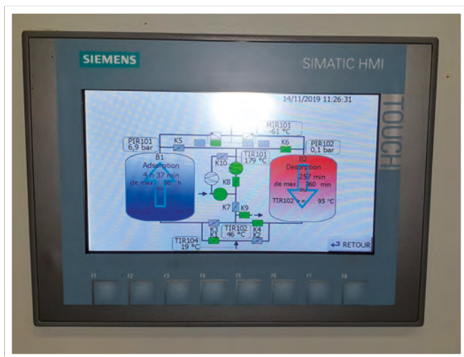
Le tableau de commande multifonction sert à gérer les fonctions du sécheur et du process tout en surveillant ses performances.
