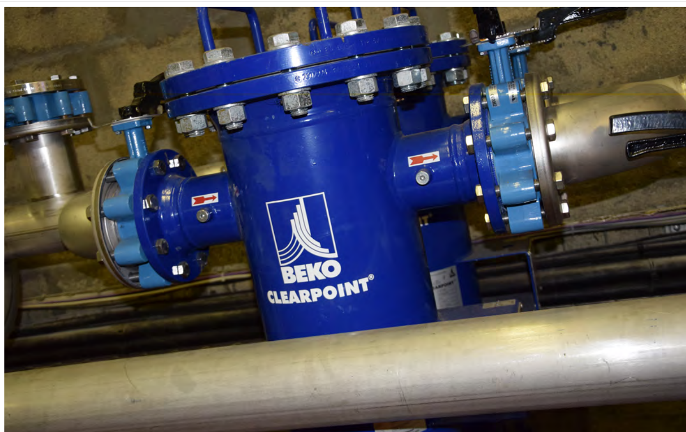
Le système de filtration CLEARPOINT installé chez le client lui permet d'éliminer efficacement l'eau, les particules solides, les poussières et l'huile contenues dans son réseau d'air comprimé
