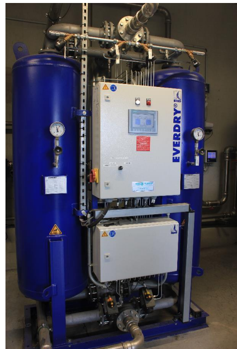
L'essiccatore ad adsorbimento EVERDRY è l'elemento centrale del sistema di trattamento
