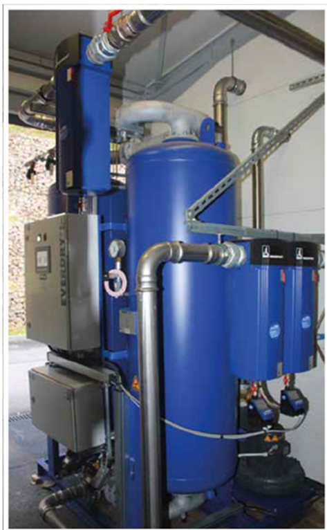
Sercem nowej instalacji przygotowania sprężonego powietrza jest osuszacz adsorpcyjny regenerowany na gorąco EVERDRY® typu FRA-V
